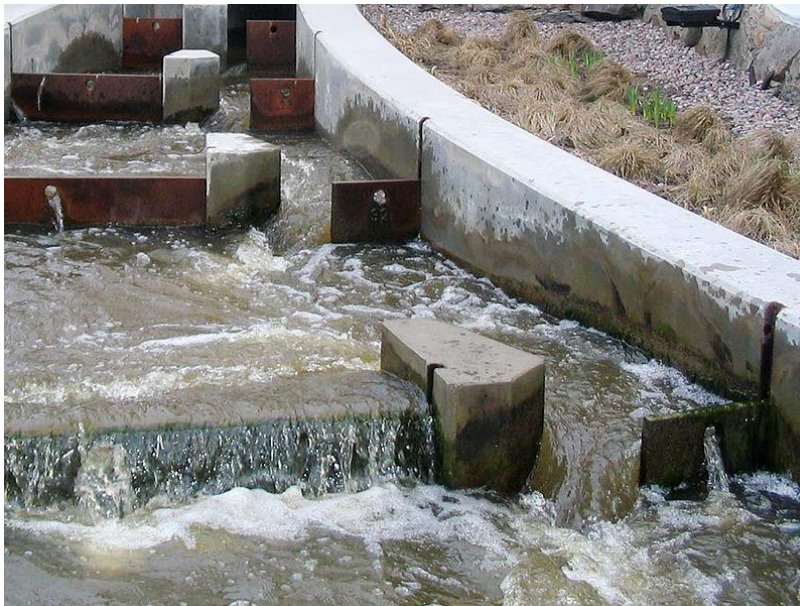
Figura F-47. Fotografía de Escalera de Estanques Sucesivos para Peces.
